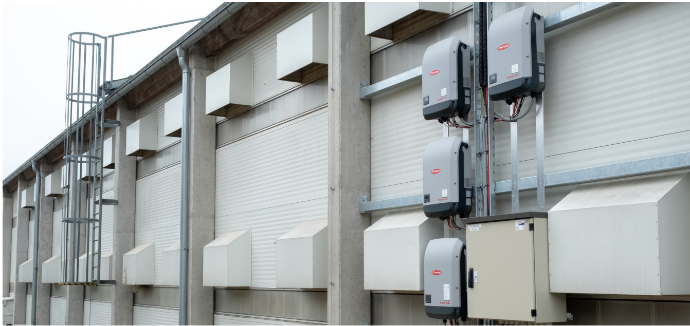
Die Geflügelzuchtanlage läuft mit 4 Fronius Wechselrichtern und dem VARTA flex storage E 120/375.
